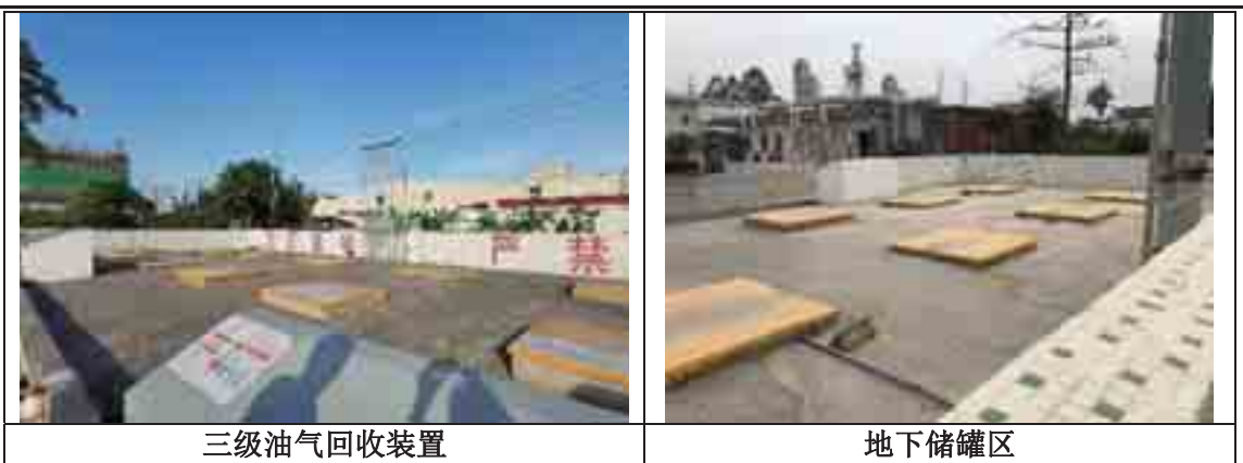
图 2.13-4 现有项目储罐呼吸废气收集/处理设备现状图
